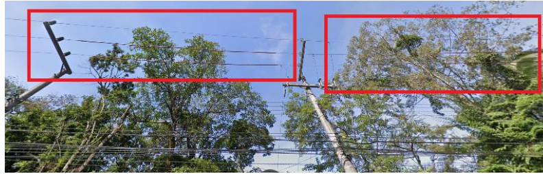
Figura 4 – Rede aérea de média-tensão com dois de seus três cabos protegidos por uma cobertura isolante, junto à vegetação.
