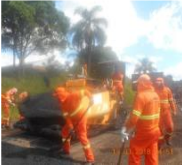
Figura 4 – Ausência de EPIs adequados
